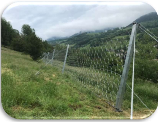
Filets de protection (2021) 125 000 €/80 000 € de subventions et 20 000 € de FCTVA (1)
